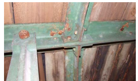
Korrosionsschäden an den Obergurten der Fachwerkträger
