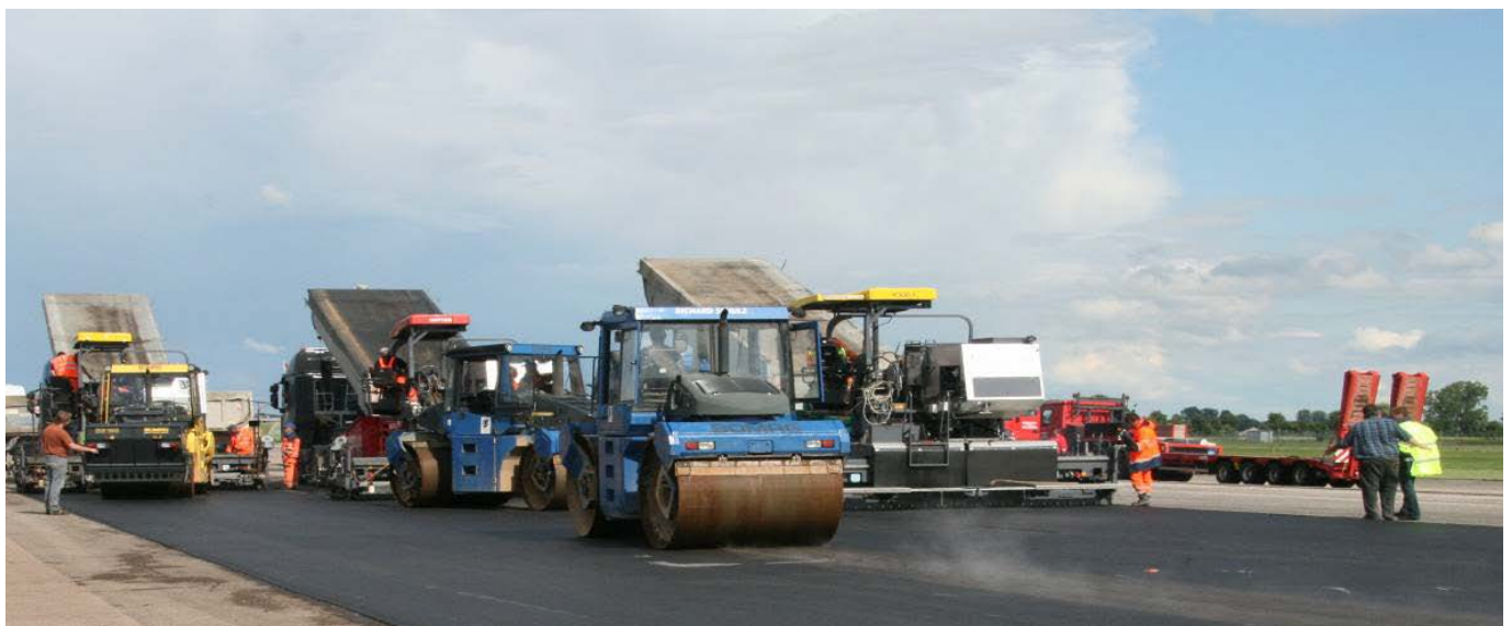
Einbau des Dünnschichtbelages mit drei Fertignern gestaffelt auf 15 m Breite (Foto: Jagdgeschwader 74, Neuburg / Donau)
