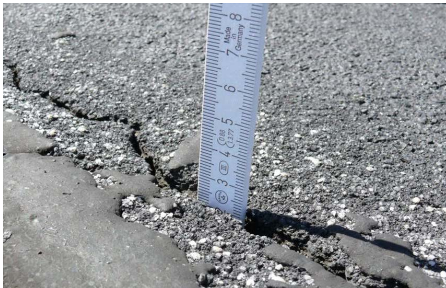
Risse in der OSS (Foto: StBA IN, Ingolstadt)
